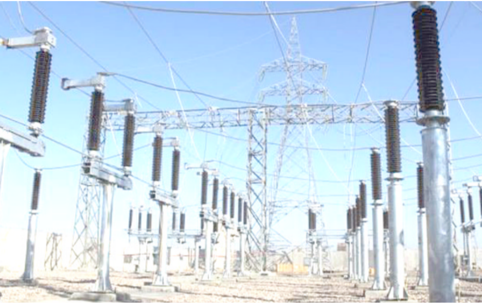
محطة جانب من محطات توليد الطاقة الكهربائية في البصرة
