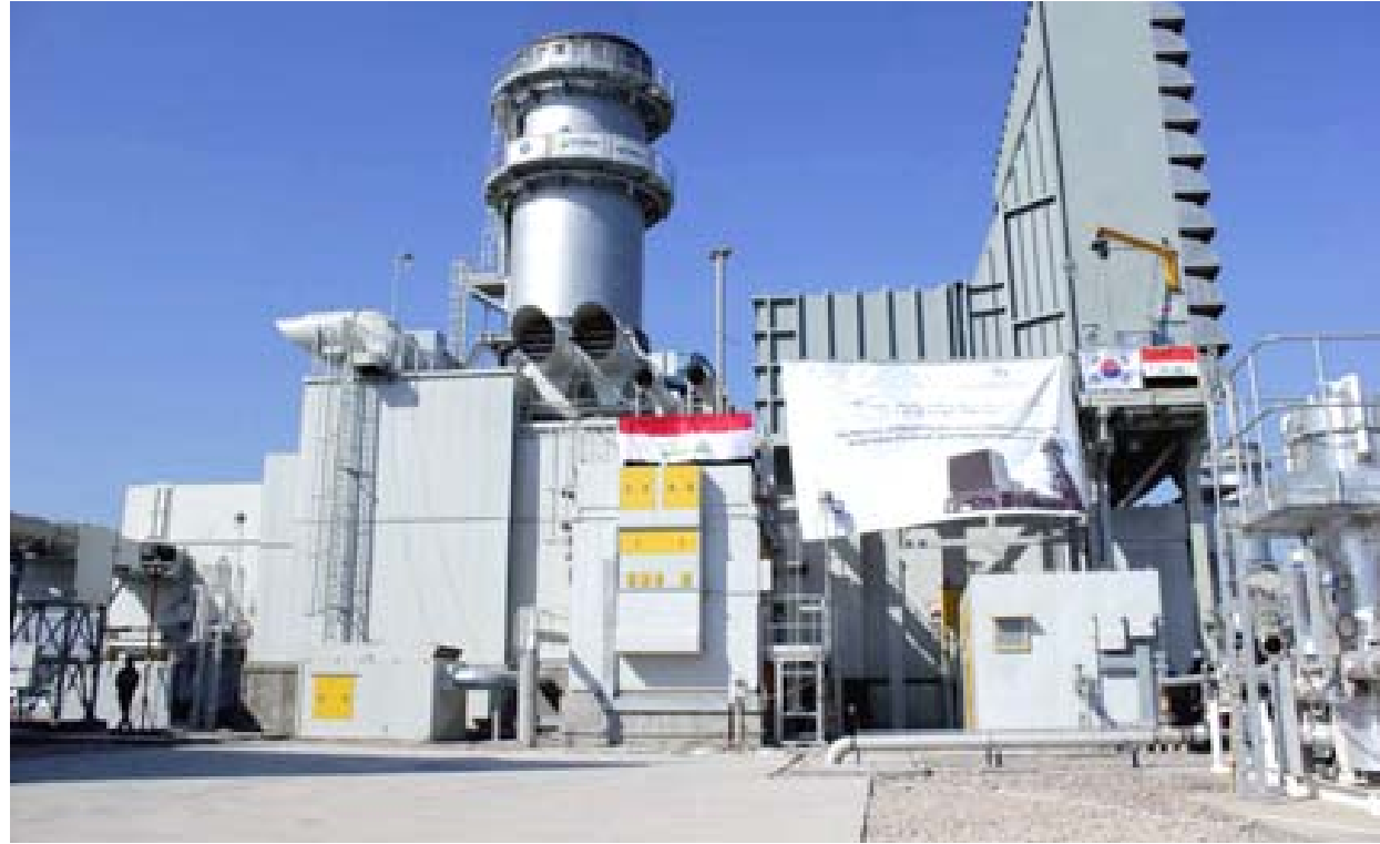
محطة: جانب من إحدى محطات الكهرباء
